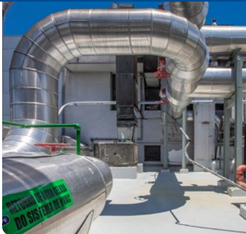
↑ La nueva Planta de Agua Helada Morumbi proporciona refrigeración para centros quirúrgicos y áreas de hospitalización, con control térmico preciso, seguro y económico
