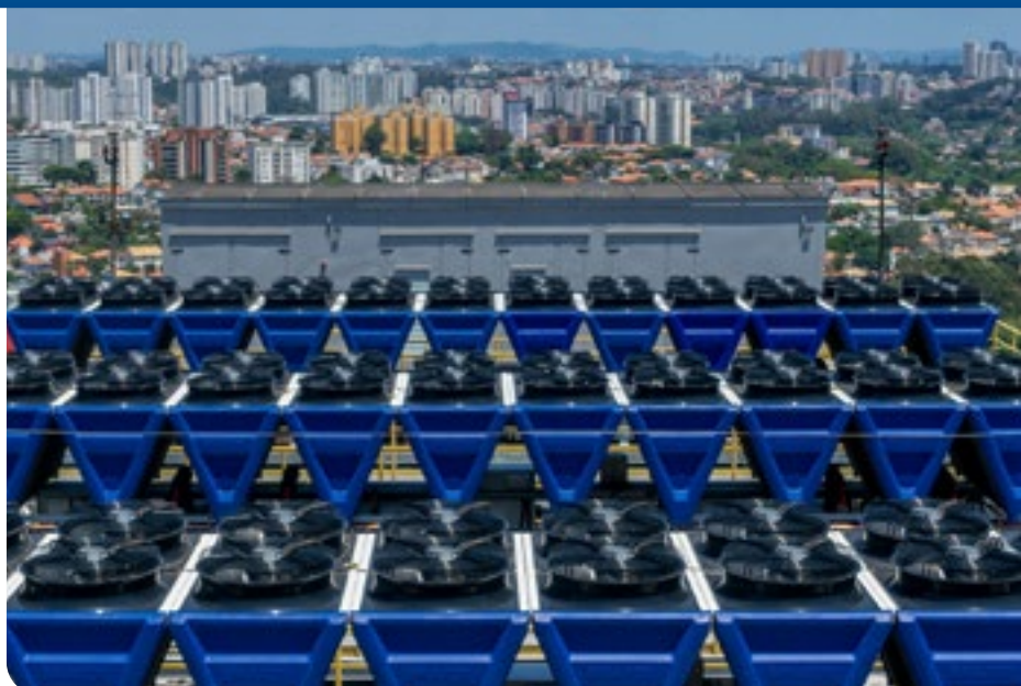
↑ Planta de agua fría de Morumbi
