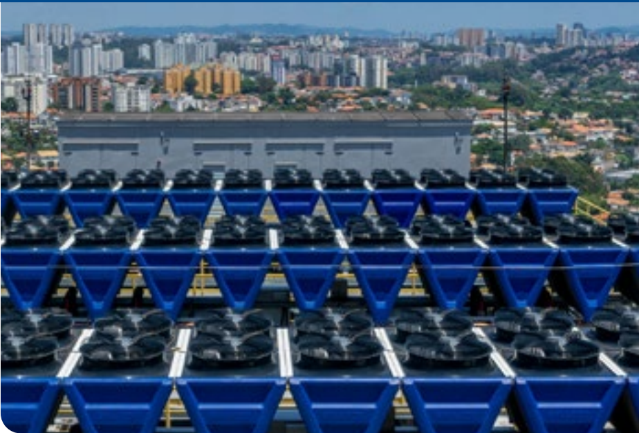
↑ Central de Água Gelada do Morumbi
