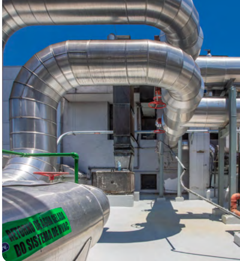
↑ A nova Central de Água Gelada do Morumbi provê o resfriamento de centros cirúrgicos e áreas de internação, com um controle térmico preciso, seguro e econômico
