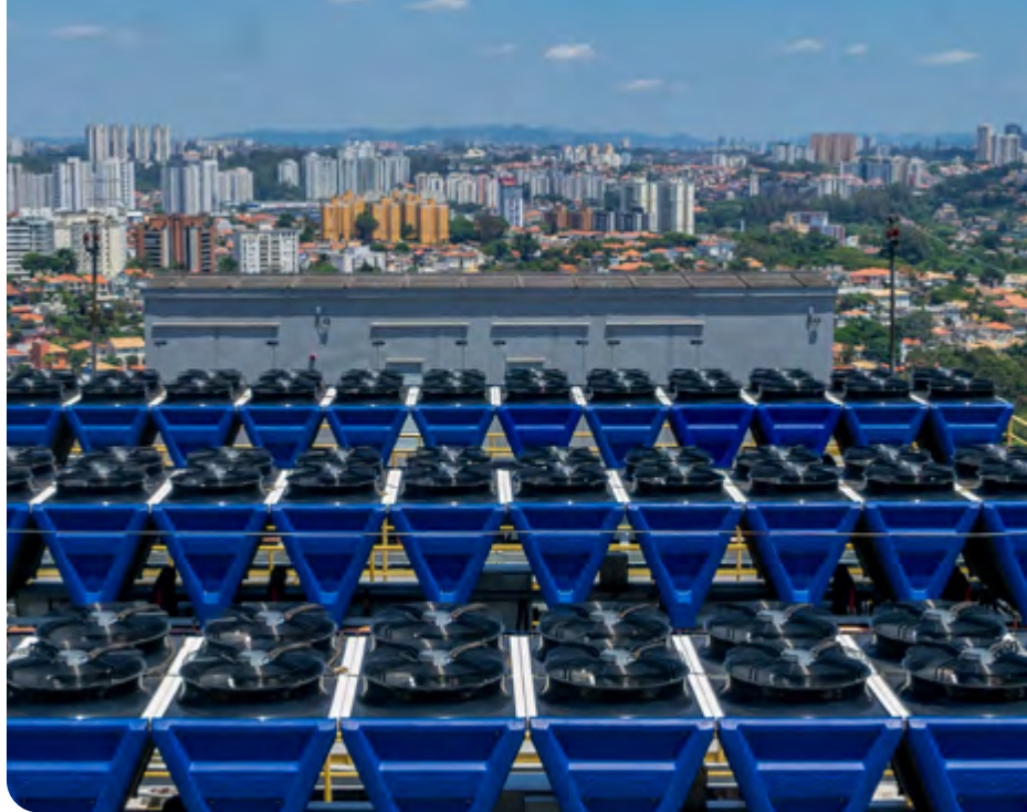
↑ Central de Água Gelada do Morumbi
