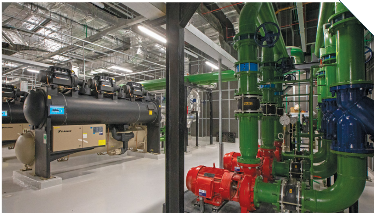
Planta de agua helada para la refrigeración de los ambientes del Centro de Enseñanza e Investigación
