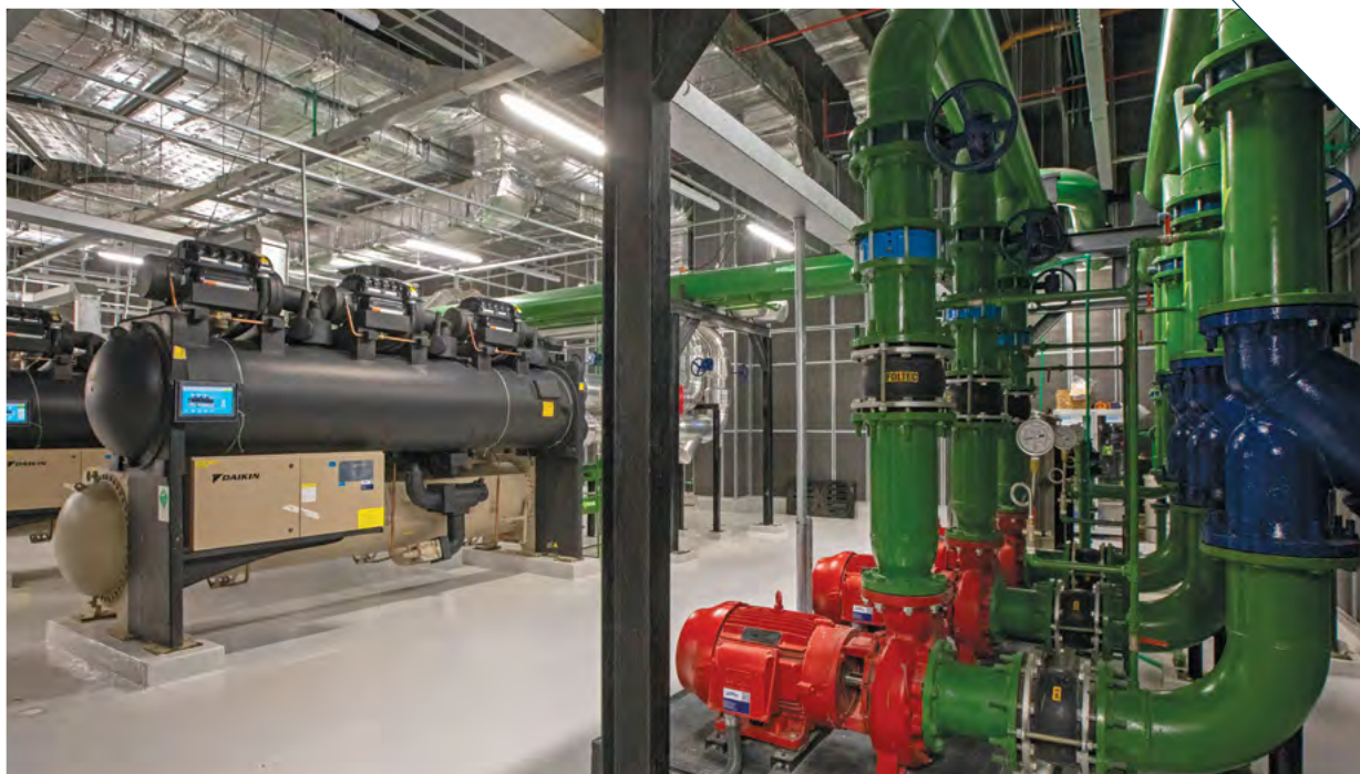
Central de água gelada para resfriamento dos ambientes do Centro de Ensino e Pesquisa
